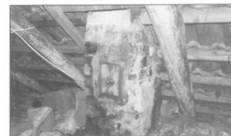
Schadhafter Schornstein durch Versottung
