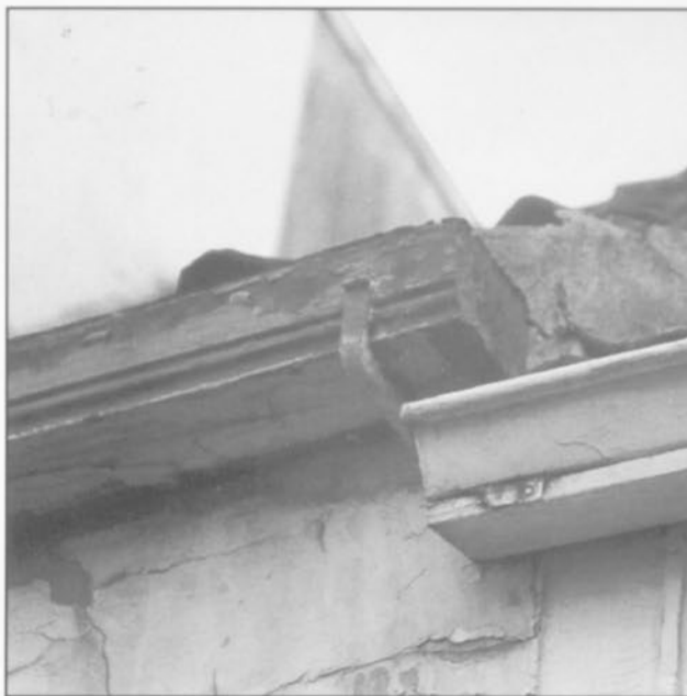
Emden – Massivholzrinne und Blechrinne, die zur Verringerung der Anzahl der Auflagepunkte auf einem Brett aufliegt.
