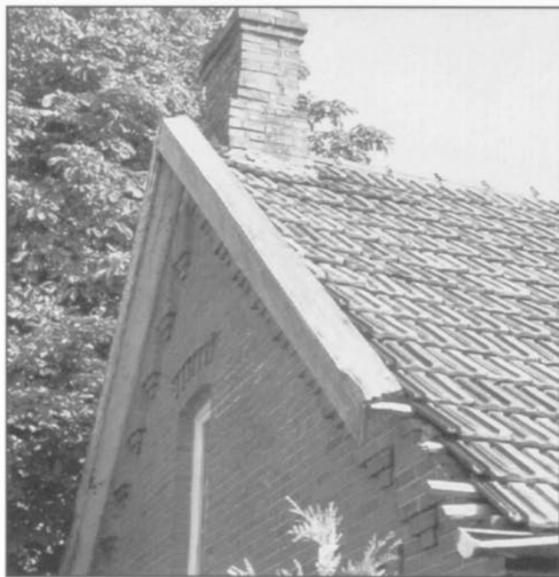
Neermoor – defekte Windfeder, vermutlich durch Sturm- einwirkung verursacht
