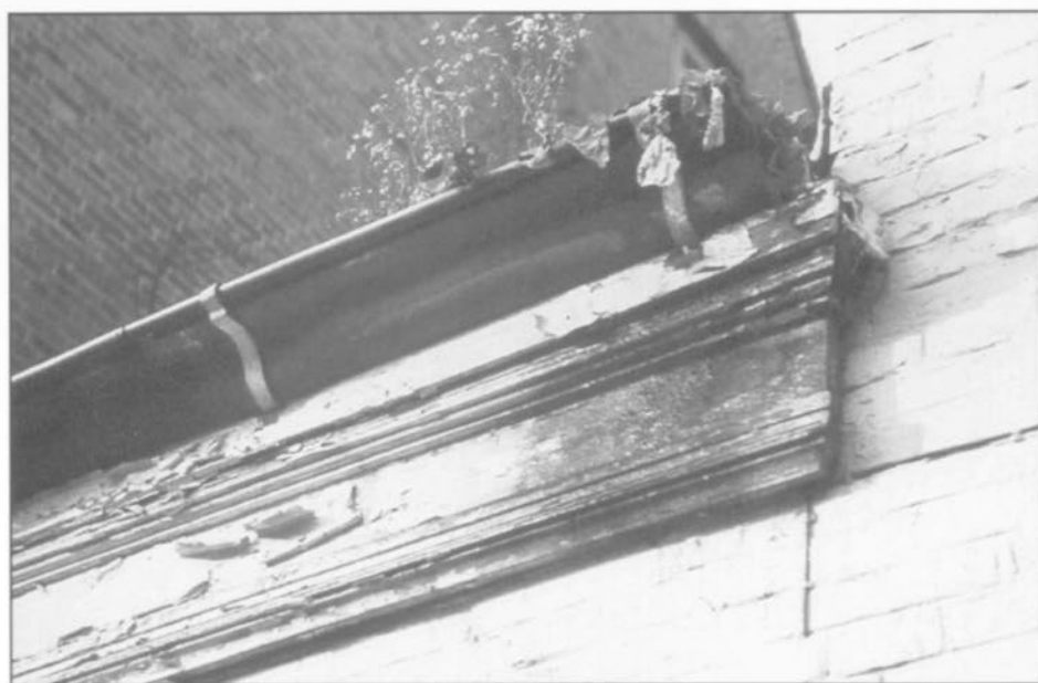
Leer – verstopfte Rinne und schadhaftes Gesims
