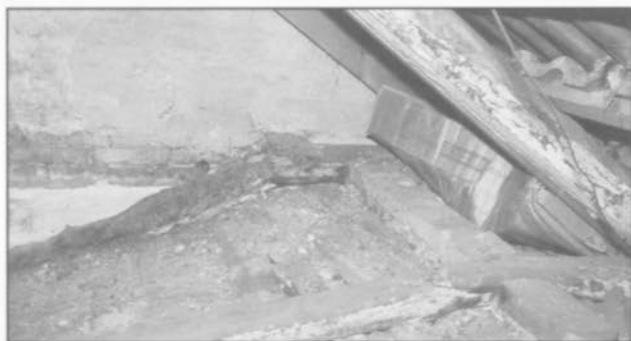
Vermoderter und gebrochener Kehlbalken
