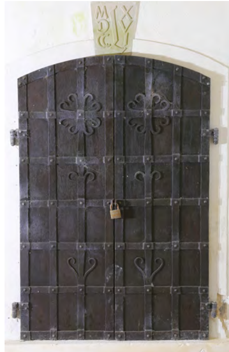
Abb. 11: Neugestalteter Zugang zur Gruft der Familie Löling in der nordwestlichen Ecke der Krypta (Foto: Stefan Krabath, NihK Wilhelmshaven)
