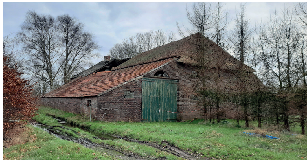
Abb. 11 Einsturzgefährdeter Gulfhof in Theene (Landkreis Aurich)
